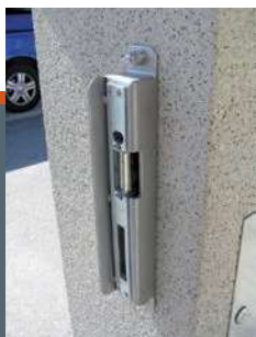
Elektrischer Türschließer bauseits
