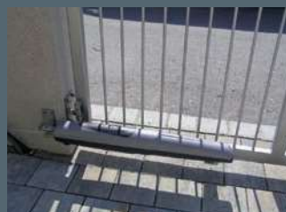
Elektrischer Türöffner wird bauseits montiert
