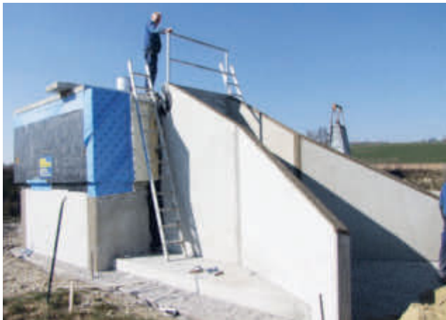
Brunnenschacht in Haag
