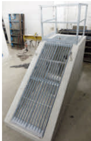
mit Prallwänden mit Edelstahlblechverkleidung
