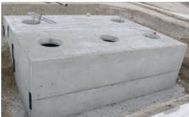
Rigolenanschlussschacht für MAN in München
